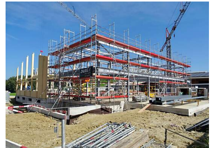
27.09.2023 Halle Flückiger Hecht in Stahl, Halle HP Lanz in Holz
